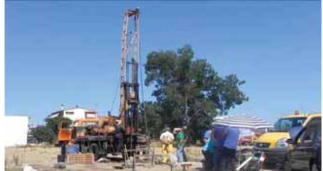
Γεωτεχνικές Έρευνες στην Β.Δ. Πελοπόννησο αμέσως μετά το σεισμό της Ανδραβίδας (Ιούνιος 2008).
