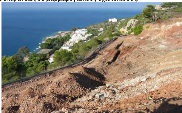
Άποψη κατολίσθησης που εκδηλώθηκε το 2006 στο πρανάς ανάκνη του Δήμου Λουτρακίου (Κόρινθος).
