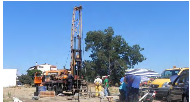
Γεωτεχνικές Έρευνες στην Β.Δ. Πελοπόννησο αμέσως μετά το σεισμό της Ανδραβίδας (Ιούνιος 2008).
