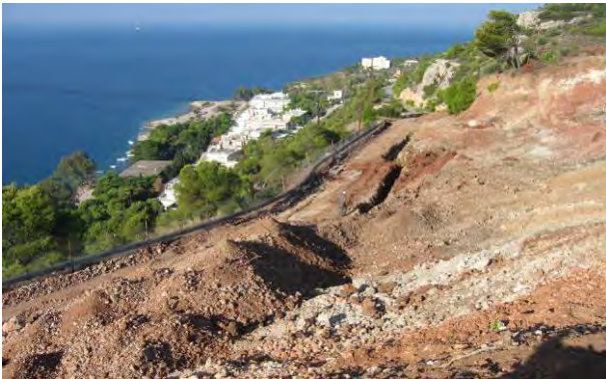
Άποψη κατολίσθησης που εκδηλώθηκε το 2006 στο πρανές ανάκτιο του Δήμου Λουτρακίου (Κόρινθος).
